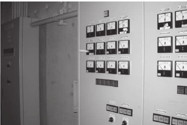
写真 47 空調設備 (操作盤)
